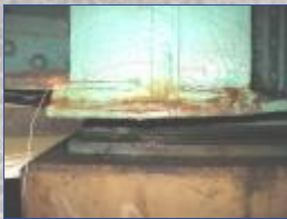
Lagerbauteile feucht und korrodiert
